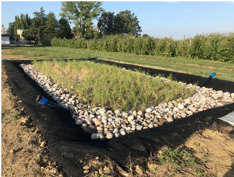
Figura 2 - Sistema di fitodepurazione (constructed wetland)
